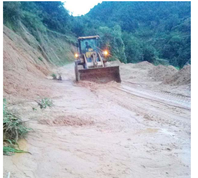
近期临翔区连降暴雨,导致小岔线K1+000-K5+000段(小铺子至岔河村、明子村公路)出现大面积塌方,车辆无法通行,严重影响岔河村、明子村群众出行安全及脱贫攻坚工作顺利推进。接到险情后,临翔区交通运输局迅速采取应急措施,组织装载机进行抢险保通,连夜奋战,目前已实现全线安全畅通。 李春富 摄
