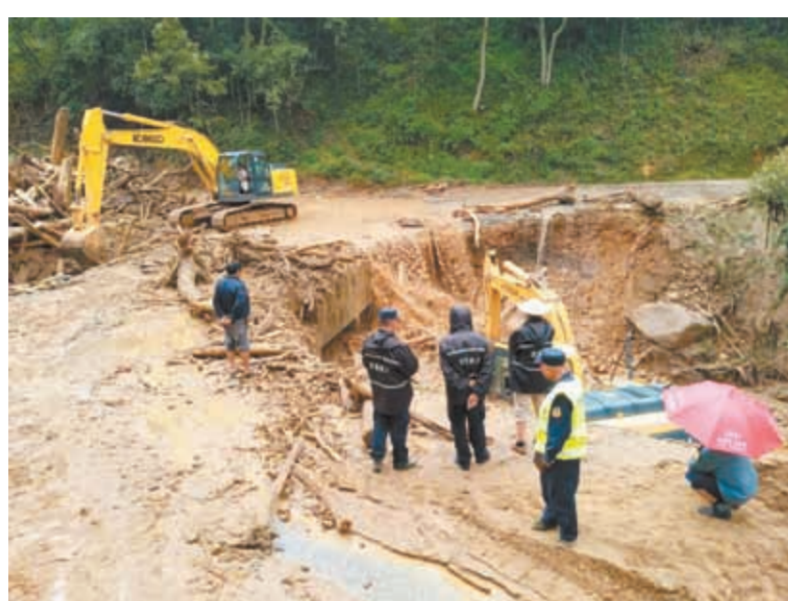
农村公路塌方现场
